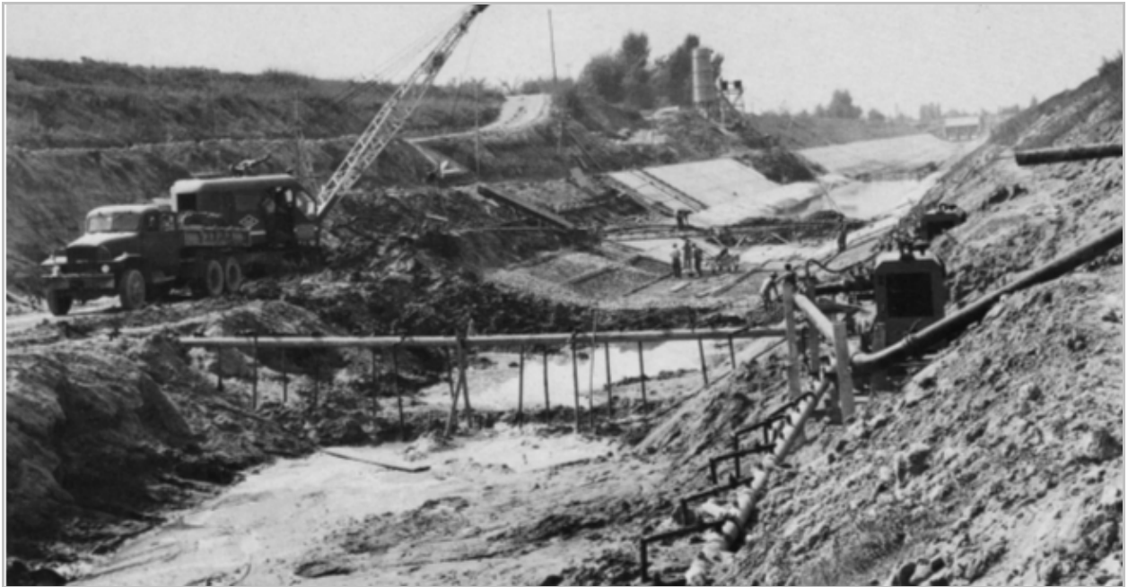
Figura 6-13. Primo tronco del Canale Emiliano Romagnolo: una fase di costruzione in prossimità della chiavica di derivazione dell'attenuatore delle piene del Reno (1960) (Alessandro Denaro e Giorgio Vighi, Dalla ricostruzione postbellica ai giorni nostri , Gabriele Corbo Editore, 1990)
